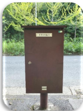
街路灯分電盤
